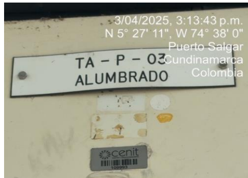
Imagen Placa de Inventario tablero de Distribución
