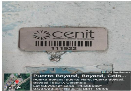
Imagen Placa de inventario Unidad de filtración
