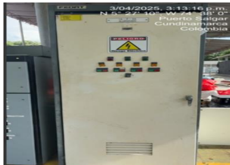
Imagen Tablero de Distribución
