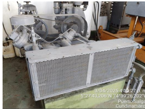
Imagen Compresor de aire
